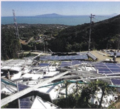
写真② 台風で壊されたEゲートのソーラーパネル
