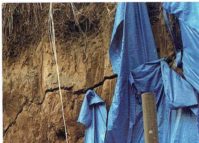
事業地入口付近の仮沈砂地の法面の亀裂
