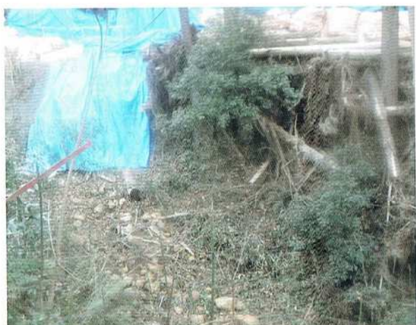
2021.2岡沢脇の作業用道路が崩れている
